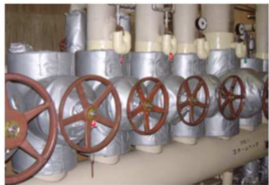
蒸気ヘッダーバルブ
